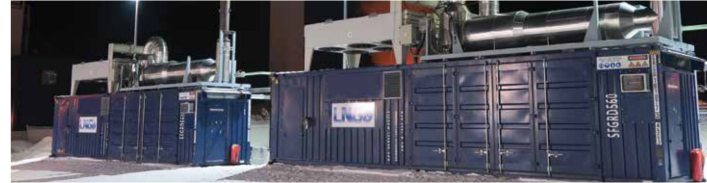
Siemens LNGo Power modules (SL), Altagas Ltd. British Columbia, Canada.
